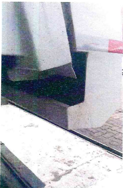
Foto 04 – Calha coletora chorume traseira
